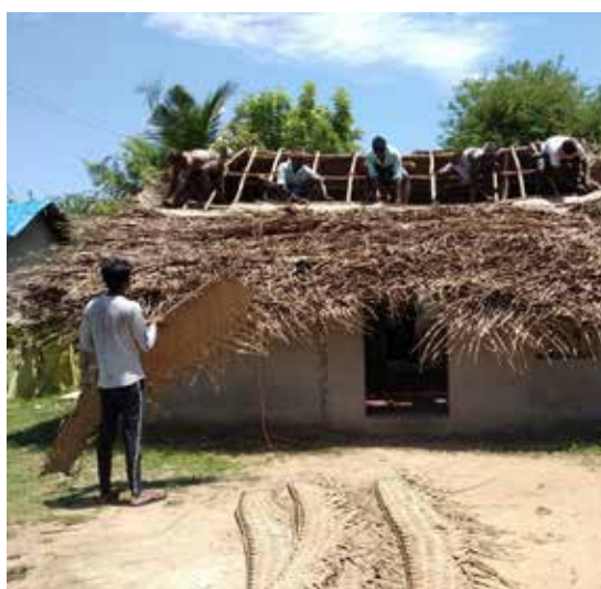
Die Palmwedelmatten zum Eindecken des Daches stellen die meisten Familien selbst her. Es gibt aber auch einen Markt für die in Heimarbeit hergestellten Matten,
