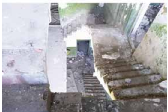
Im ganzen Gebäude lag Bauschutt und Abbruchmaterial herum, das per Hand herausgebracht und sortiert wurde.
